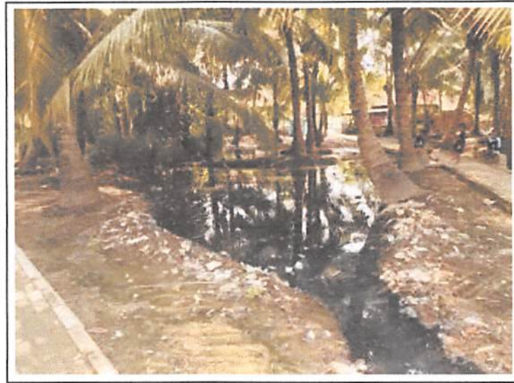
Gambar 8. Contoh Kondisi Genangan di Samping Jalan Lingkungan (Sumber: Peraturan Menteri Pekerjaan Umum Nomor: 14/PRT/M/2018)
