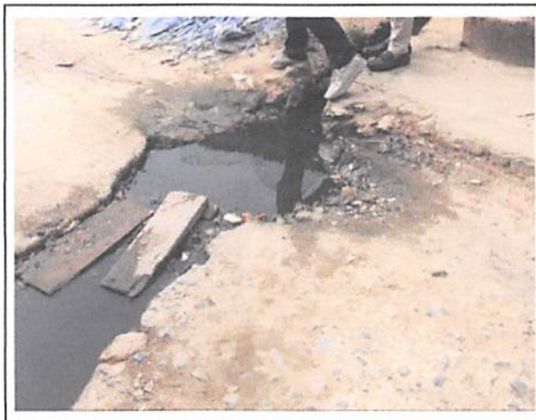
Gambar 5. Contoh Kondisi Permukaan Jalan Lingkungan yang Rusak
